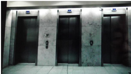
1階 エレベーター
